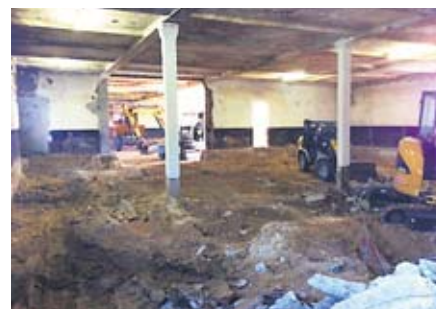
So sah es während der Umbauarbeiten im ehemaligen Schweinestall auf Gut Stellmoor in Ahrensburg aus
